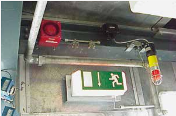
Wykrywanie gazu za pomocą alarmu optycznego i akustycznego: 🔊-Syrena DS 10 ATEX i 🚨-lampa błyskowa CWB-ATEX.
