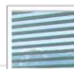
Brak widocznych połączeń pionowych
