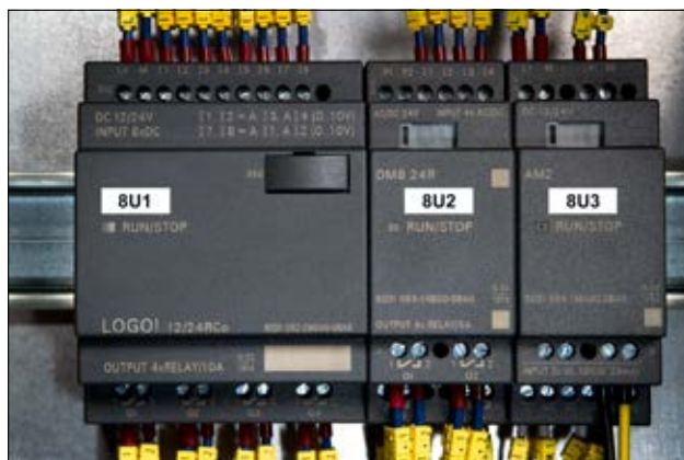
Wyraźna identyfikacja za pomocą etykiet ułatwia zarządzanie przewodami sieciowymi i kablami.
