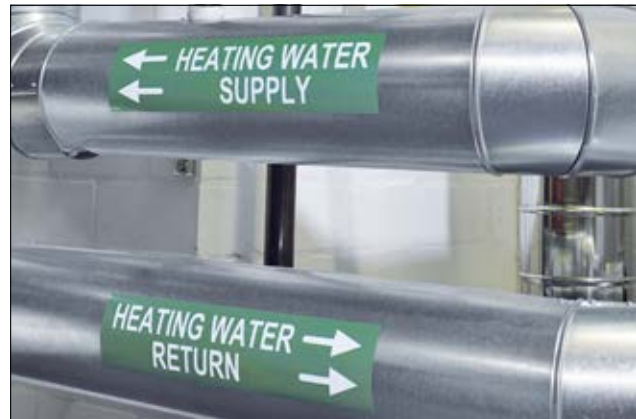
Duże i dobrze widoczne oznakowanie rur.
