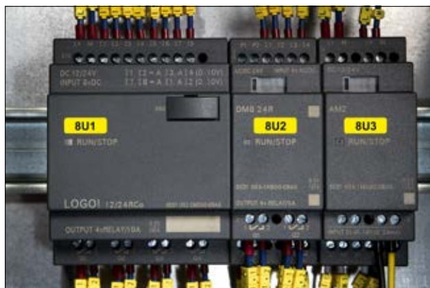
Zastosowanie w rozdzielni.
