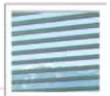
Brak widocznych połączeń pionowych
