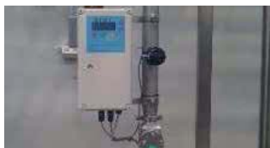
Połączenie mocowane na ścianie panelu kontrolnego w zakładzie wody butelkowanej. (Australia) Serie TH387.
