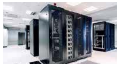
Połączenia pomiędzy generatorami UPS dla pomieszczenia serwerowni. (Nowa Zelandia) Serie TH405.
